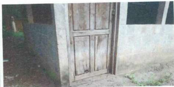
Foto 3: Sustrucción de puerta
